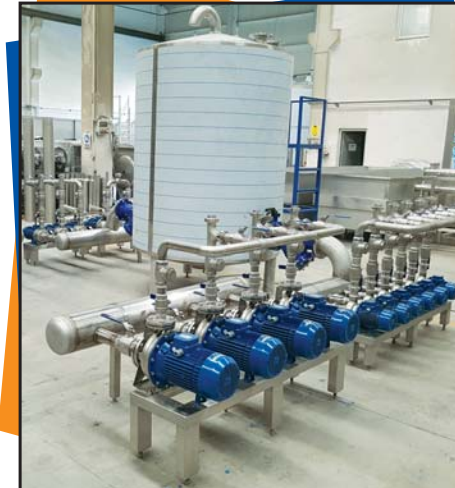
Merkezi Soğutma Sistemi Central Cooling System
