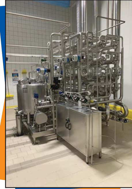
Ultrafiltrasyon Ünitesi Ultrafiltration Unit
